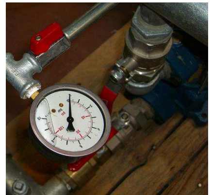
Figure 5: Remplacement du manomètre à la sortie avec le transducteur de pression
