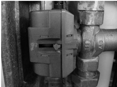
Aspiration eau de ville dans le disconnecteur
