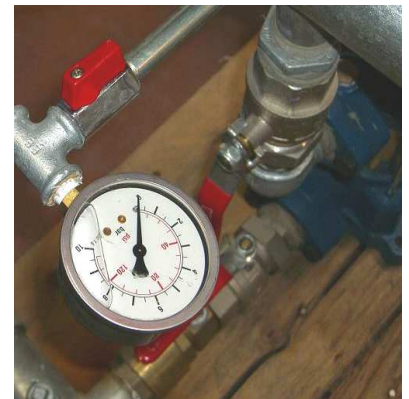
Fig. 7: manomètre à remplacer
