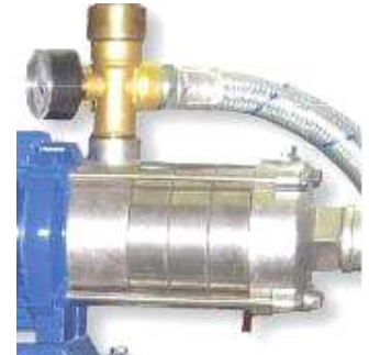
Fig 6: sortie de pompe multi-étage avec manomètre à remplacer par le capteur
